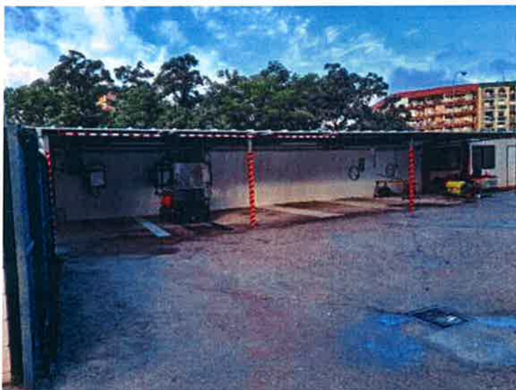
PORCHE LA SALUD PARA PROTECCION DE CARRETILLAS ELEVADORAS
